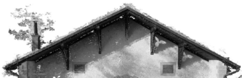
Figure 3 - Mise en évidence du bruit au niveau du toit sur un nuage de points issu du relevé par drone
